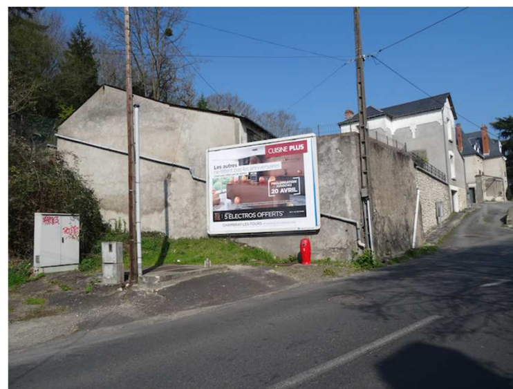
Dispositif mural dépassant les limites du mur
