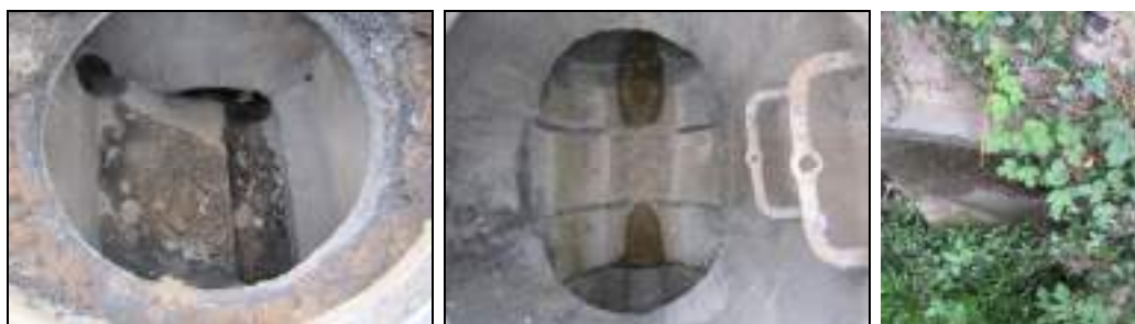
Photo 1, 2 et 3 : Infiltration dans le regard 0338 rue des Fontenelles et écoulement temps sec à l'exutoire 20
