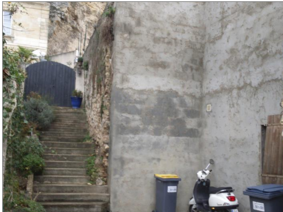
Reprise d'un mur de soutènement avec un enduit ciment peu approprié au contexte paysager largement dominé par les murs en moellons anciens
