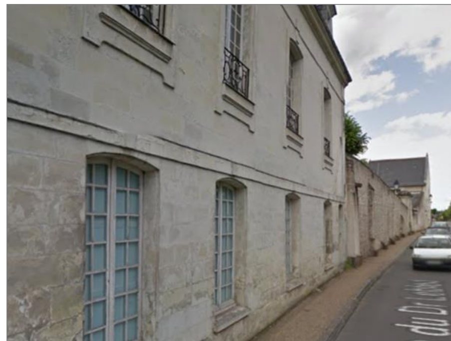
Menuiseries blanches (anciennes) d'un bâtiment de type maison de maître. L'absence de couleur altère le dynamisme de la façade
