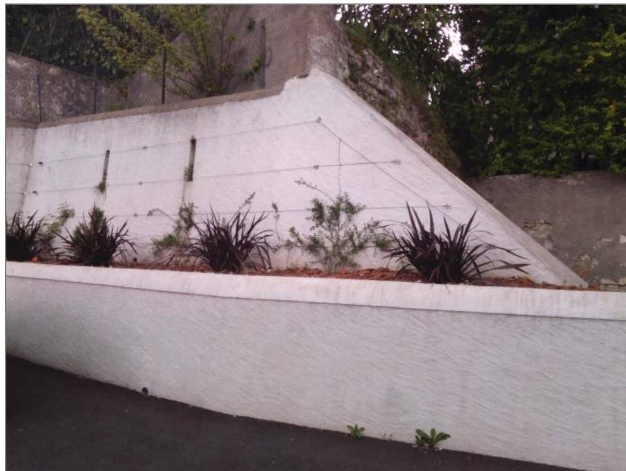
Reprise d'un mur de soutènement avec une teinte et une finition qui tranchent avec les murs anciens (rue du Docteur Lebled)
