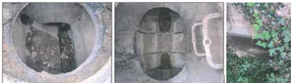
Photo 1, 2 et 3 : Infiltration dans le regard 0338 rue des Fontanelles et écoulement temps sec à l'exutoire 20
