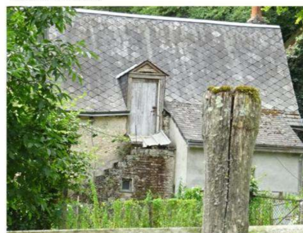
Escalier en brique permettant l'accès aux combles d'un bâtiment rural situé à Bel-Air
