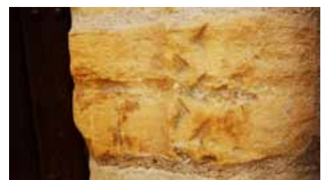
Marques sur le porche de l'église correspondant probablement à l'inondation du 3 juin 1856.
