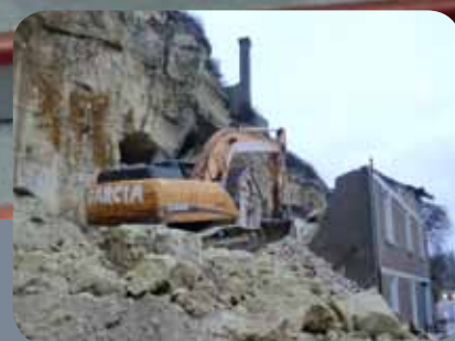
Effondrement du coteau : démolition des habitations p. 17
